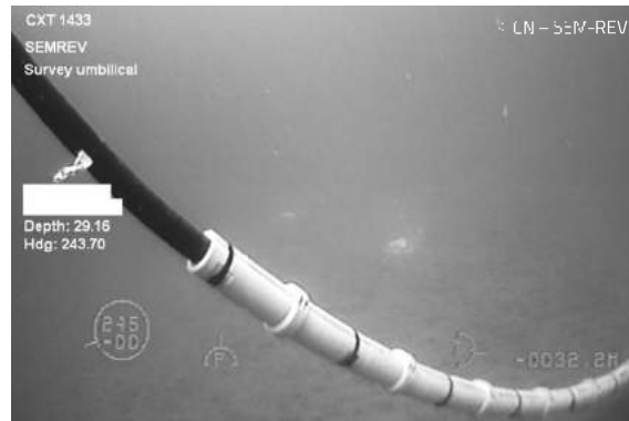
FIGURE 9 : PHOTOGRAPHIE DU CÂBLE OMBILICAL DE L'ÉOLIENNE FLOATGEN - SECTION DU POINT DE TOUCHE AVEC LE FOND MARIN.
