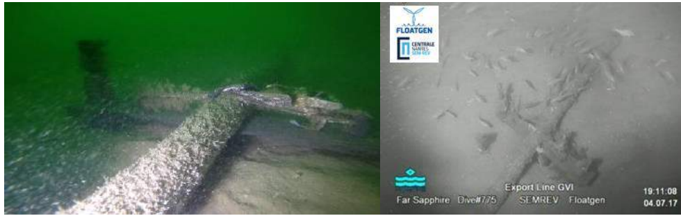
FIGURE 44 : PHOTOGRAPHIES D'EQUERRES DE STABILISATION DES CABLES ELECTRIQUES. BW IDEOL & CN – SEM-REV)
