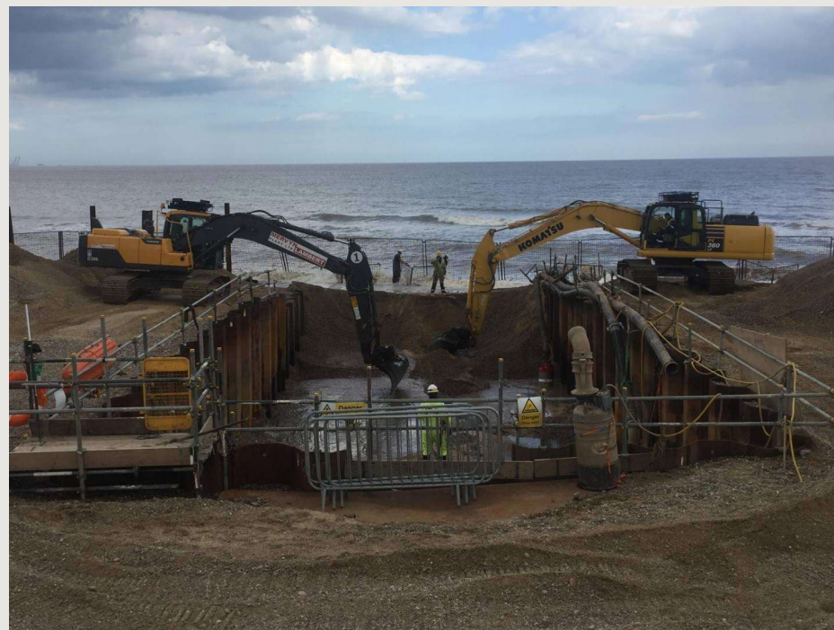
Atterrage/Chambre de jonction
