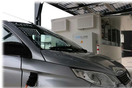
Installation de test et pilotage (BMS) sur le microgrid IFPEN, étude des systèmes de stockage Redox – © IFPEN
